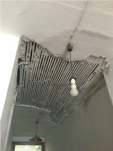
Unser Funkhaus fängt schon an, sich selbst zu sanieren.
